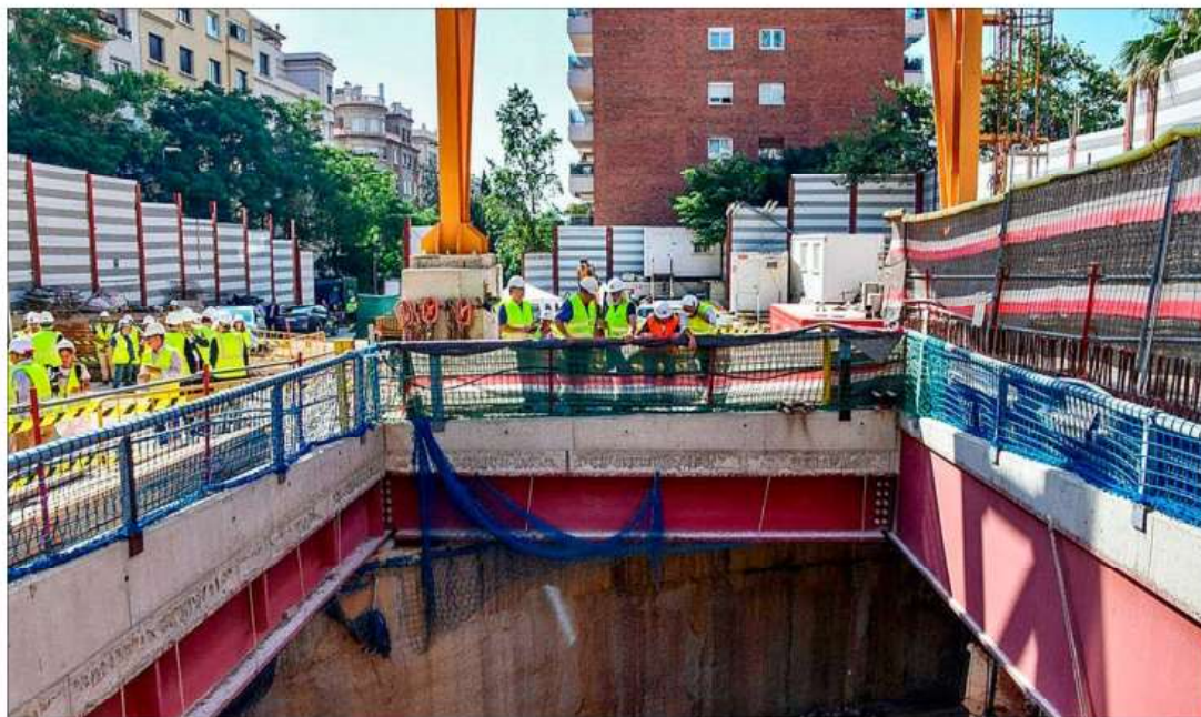
Operarios observan la llegada de la tuneladora al tramo central de la L9. E. M.
